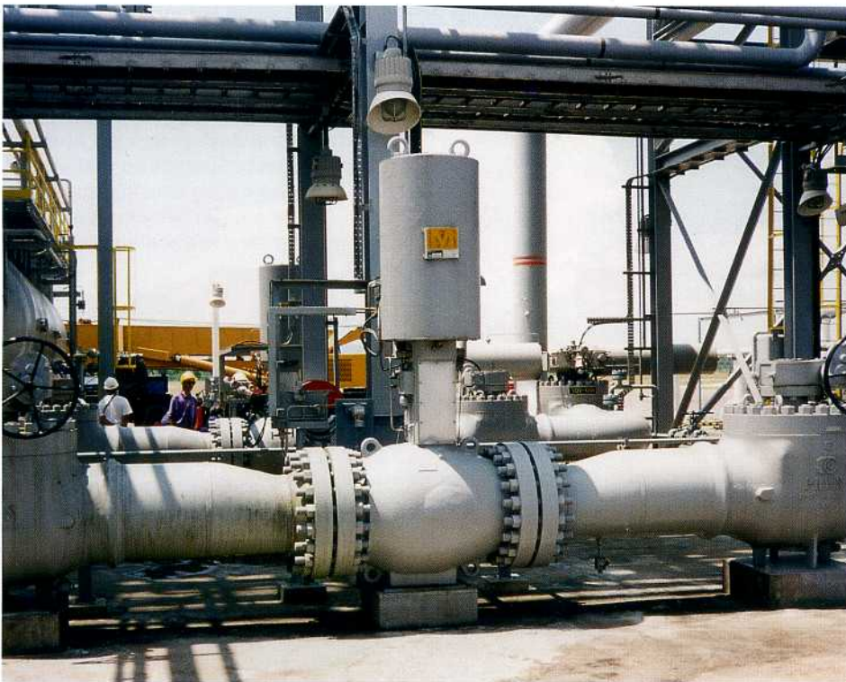
Клапаны редуцирования давления 20" ANSI 900 на газовом терминале, Малайзия
